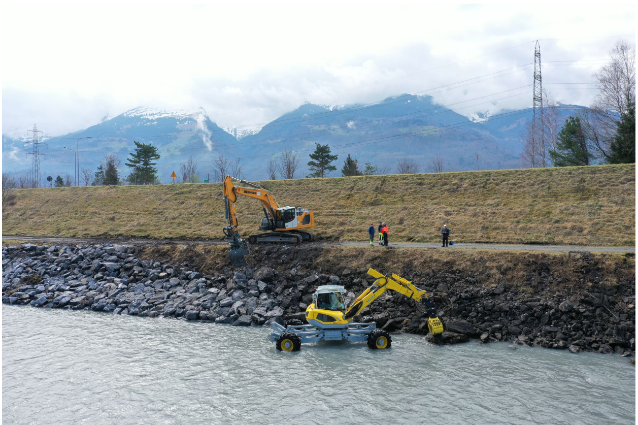
Sofortmassnahme linksseitiger gesetzter Blockwurf (km 49.6 - km 49.7), Frühjahr 2025
